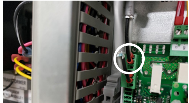
FIGURA 89 Verifique si Modbus está conectada a la placa del PLC
